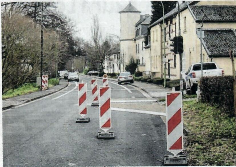
Die Ampel ist defekt, deswegen soll eine Querungshilfe in der Schillingsstraße für mehr Sicherheit sorgen. Foto: Köchling
